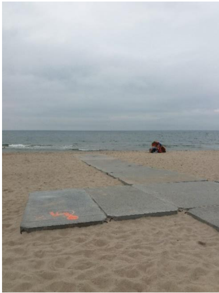
Fot. 08. Zbyt duże i nieregularne szczeliny pomiędzy elementami betonowymi
