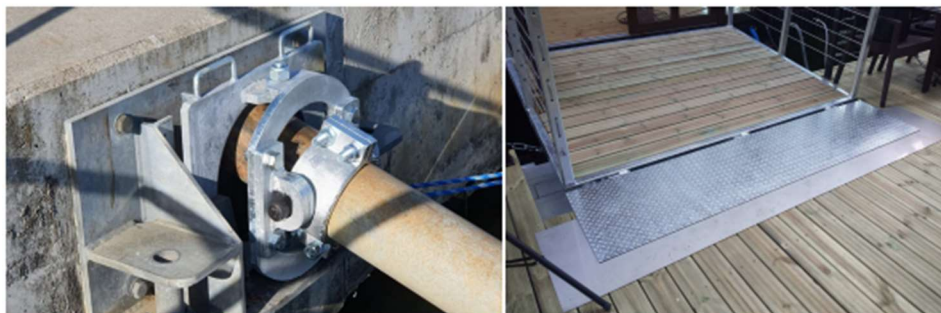
Fot. Przykład mocowania do żelbetowego fundamentu oraz trapu zejściowego, autor zdj. UMWP
