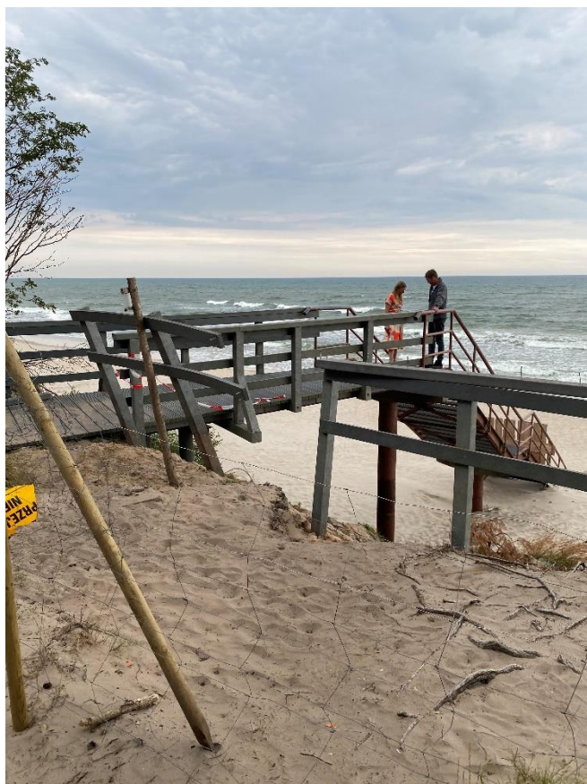
Ilustracja 3. Zdewastowane schody i uszkodzone barierki
