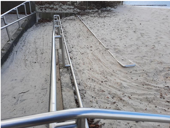
Ilustracja 2. Zasypany podjazd dla osób ze szczególnymi potrzebami
