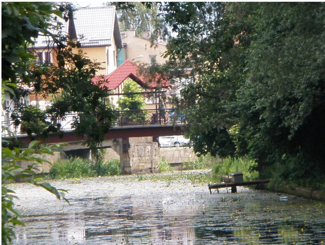
Rys. 7.3. Kładka dla pieszych w centrum miasta – widok od strony planowanej przystani. Za kładką widoczne pozostałości po zburzonym moście będące istotną przeszkodą nawigacyjną.
