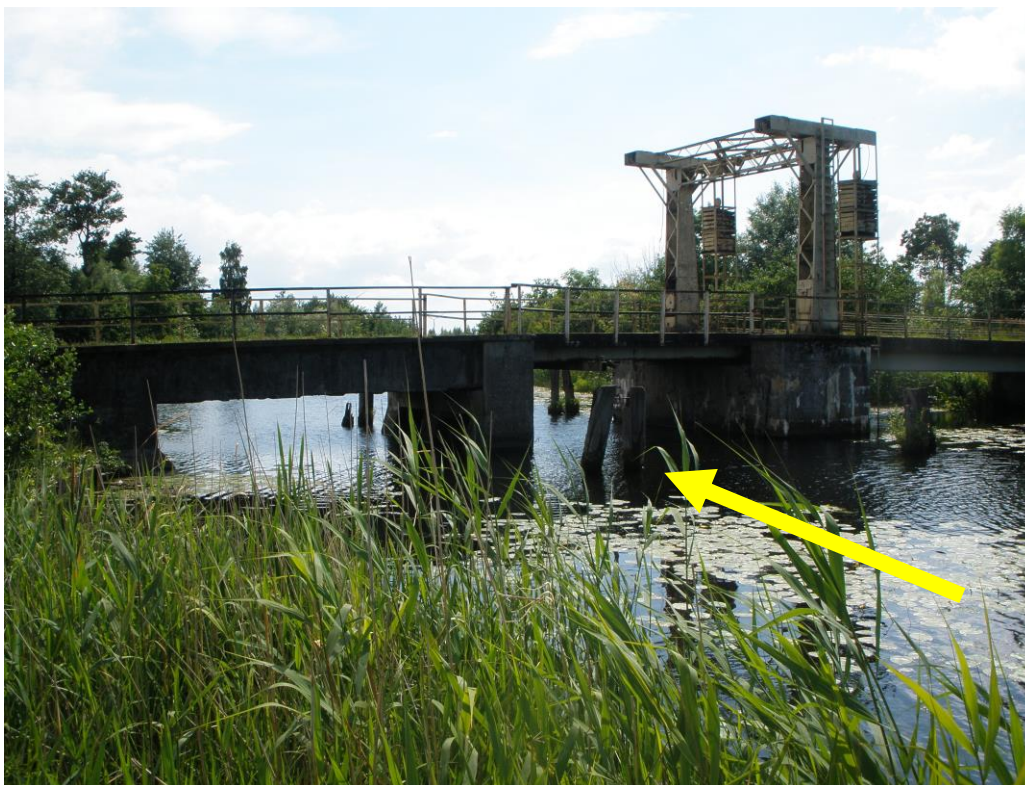
Rys. 4.3. Zarośnięty brzeg oraz widoczne zdewastowane dalby przed wejściem pod most w Tujsku.
